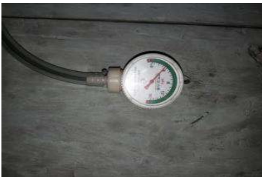
Gambar 2. Tekanan gas pada Manometer
